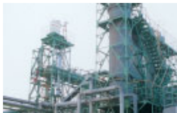
ボイラー脱硫設備(高岡)
