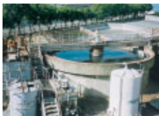
排水処理設備
