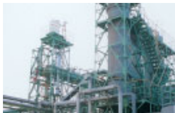
ボイラー脱硫設備(高岡)
