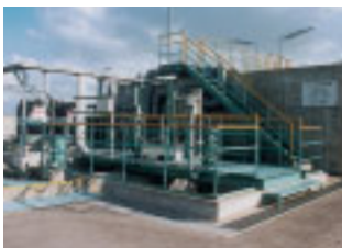
排水処理設備
