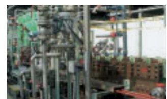
ガス拡散電極設備(名古屋工場)
