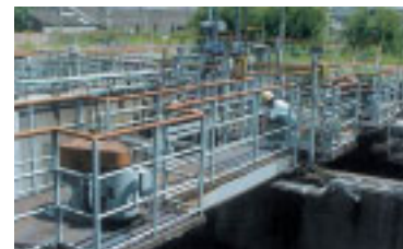
排水処理設備(名古屋)
