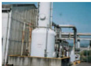
塩素除害設備
