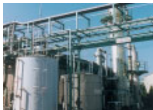
排煙脱硫設備
