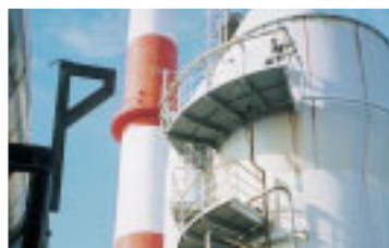
ボイラー脱硫塔(徳島)
