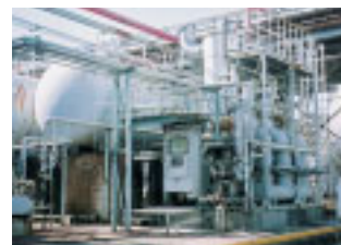
大気排出除害設備
