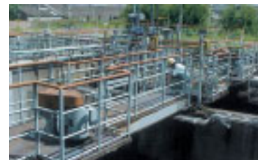
排水処理設備(名古屋)
