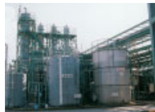
塩素除害設備
