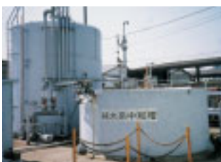
排水処理設備
