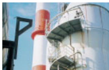
ボイラー脱硫塔(徳島)
