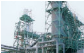
ボイラー脱硫設備(高岡)
