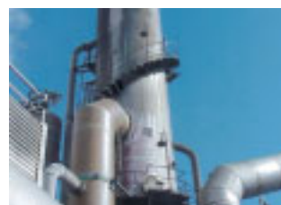
大気排出除害設備
