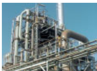
廃液燃焼設備
