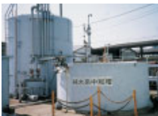
排水処理設備
