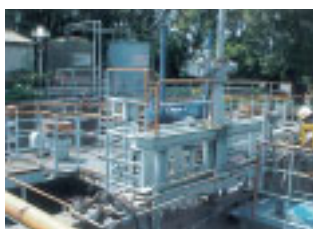
排水処理設備
