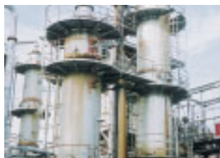
廃液燃焼設備
