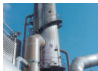
大気排出除害設備
