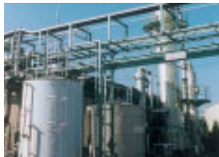
排煙脱硫設備
