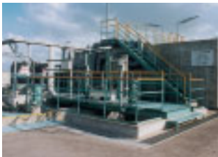
排水処理設備
