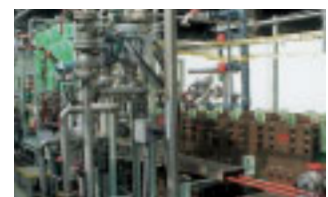
ガス拡散電極設備(名古屋工場)
