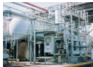
大気排出除害設備
