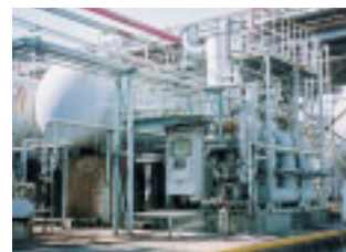
大気排出除害設備
