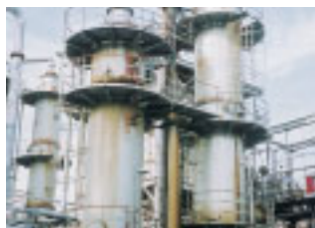
廃液燃焼設備
