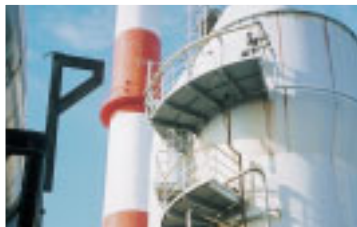
ボイラー脱硫塔(徳島)
