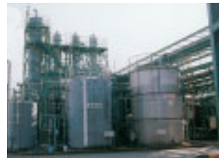
塩素除害設備
