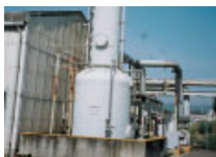
塩素除害設備
