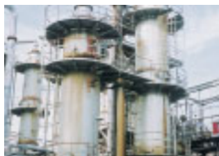
廃液燃焼設備
